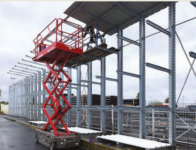
Installation en extérieur en cours de montage, avec colonnes et bras en acier galvanisé à chaud anticorrosion (GBG Concept)
