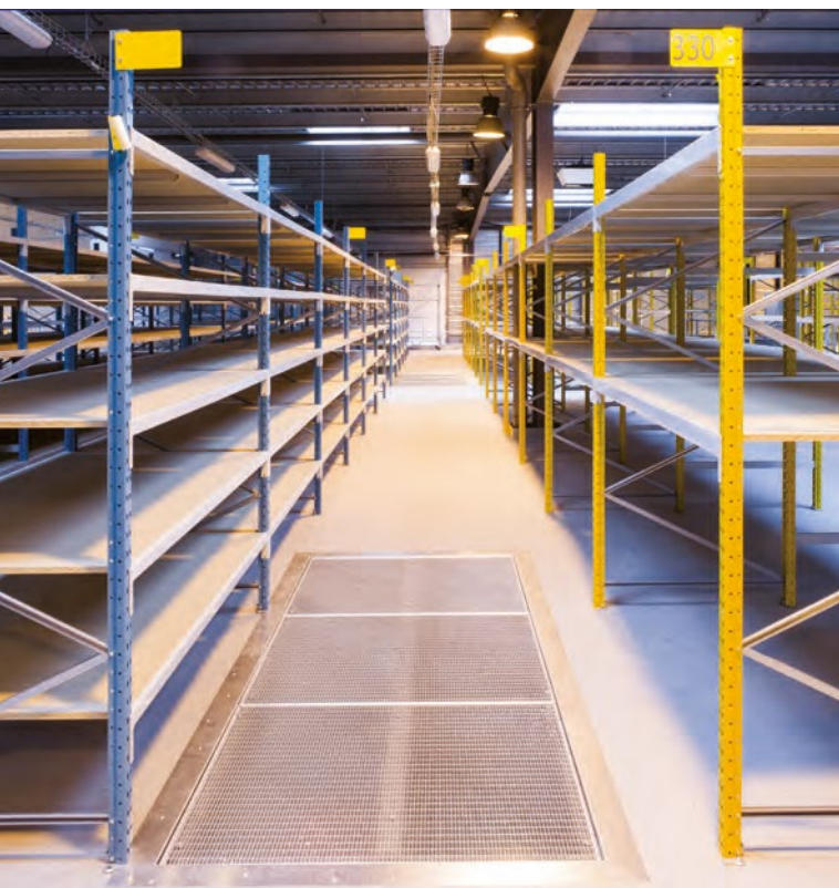
Implantation de rayonnages personnalisés par un affichage numérique et des coloris différents, pour une identification rapide et efficace des zones de stock des pièces détachées
