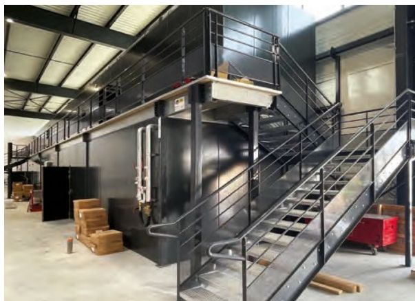
Passerelle de contrôle, installée au-dessus des zones machines avec accès ERP PMR (GBG Concept)
